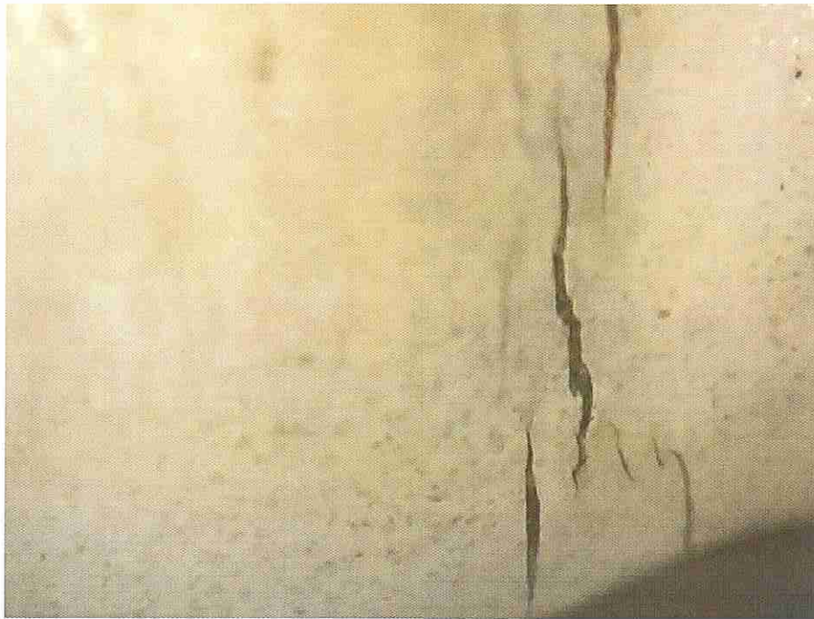
Фото 10. Растрескивание лакокрасочного покрытия, увеличено.
