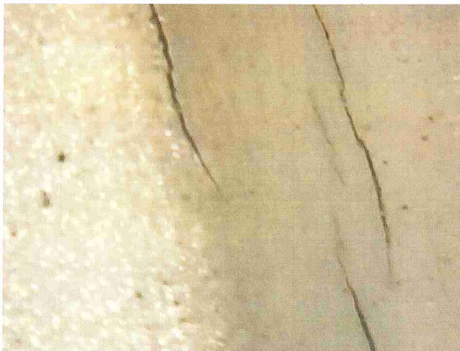
Фото 11. Растрескивание лакокрасочного покрытия, увеличено.
